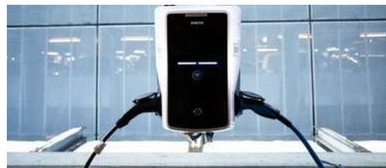
Muligheter for lading av el-bil i parkeringshus
